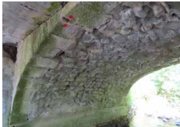
Fissures à chauves-souris sous la voûte d'un pont.
