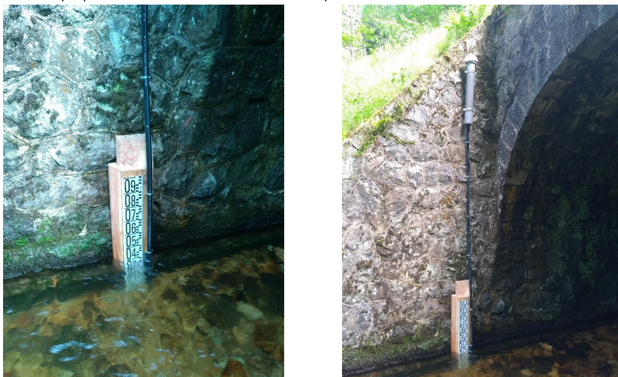
Matériel installé sur chacun des sites
