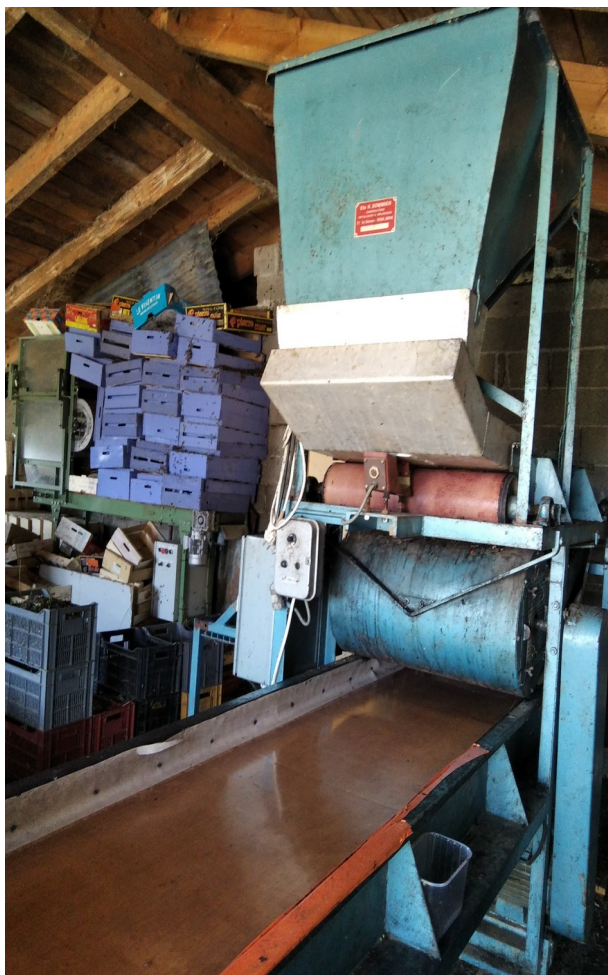
Figure 28 - Ventileuse électrique avec tapis roulant (Ardèche).
