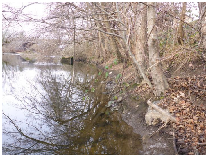
Amorce d'érosion actuellement jugulée par l'effet hydraulique de l'ouvrage (Cesame, 2018).
